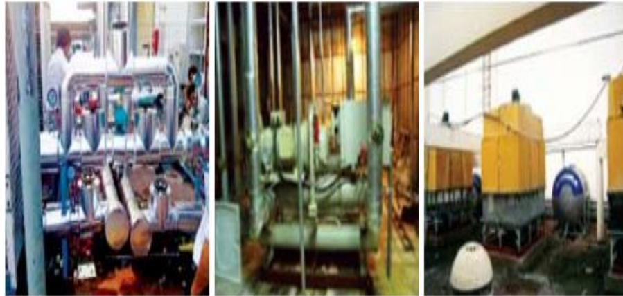
Hình 1. Hệ thống làm lạnh Chiller trung tâm giải nhiệt bằng nước
