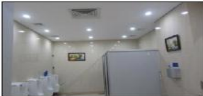
Hình 2. Hệ thống đèn led trong nhà vệ sinh TTCP
