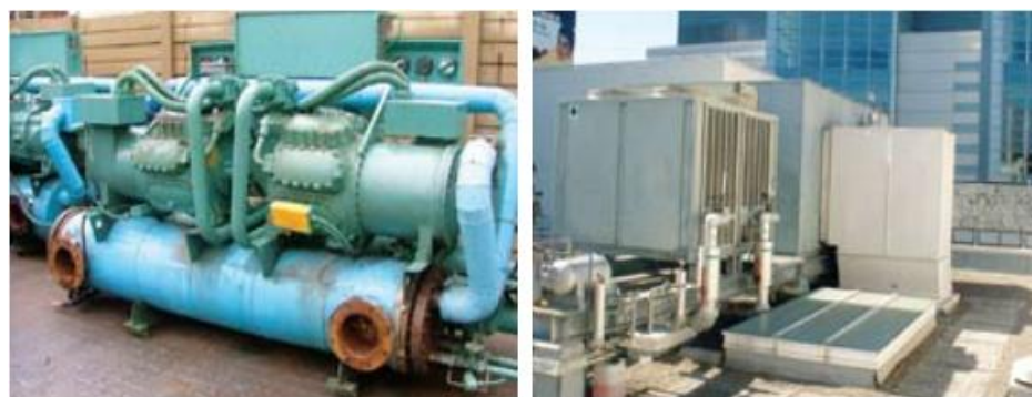
Hình 2. Hệ thống Chiller mới hiệu suất cao
